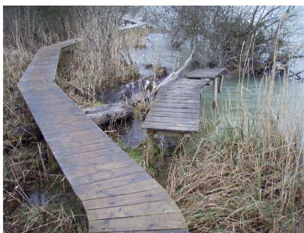
Figure E-SE_2 : Ponton riverain dégradé par l'érosion dans la Réserve naturelle de Cheyres
